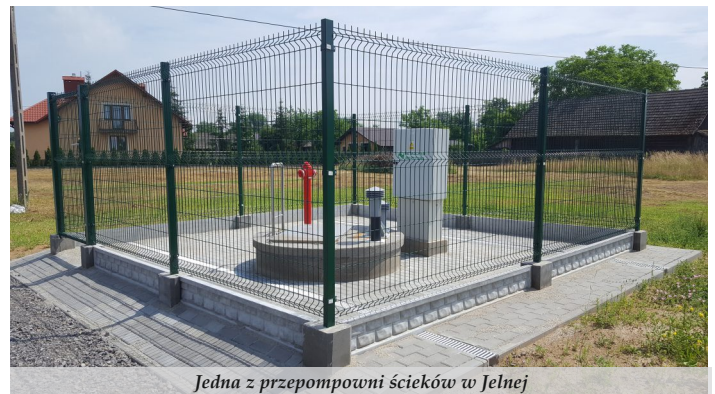
Jedna z przepompowni ścieków w Jelnej
